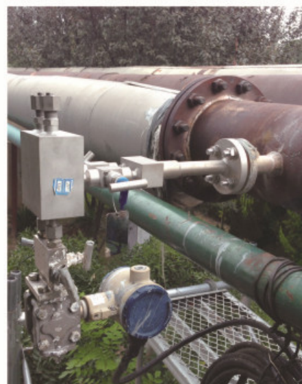
中国石油化工股份有限公司 天津石化分公司 介质：过热蒸汽 管外径×壁厚：φ219×4.5mm 压力：1.20MPa 温度：300℃
