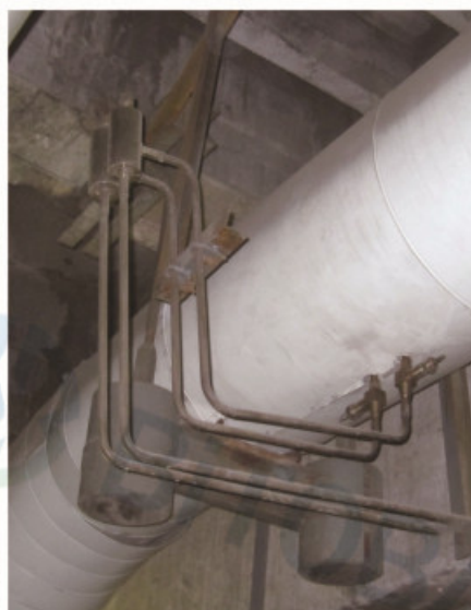
中国石油抚顺石化分公司热电厂 介质：主蒸汽计量 管外径×壁厚：φ273×18mm 压力：10MPa 温度：550℃
