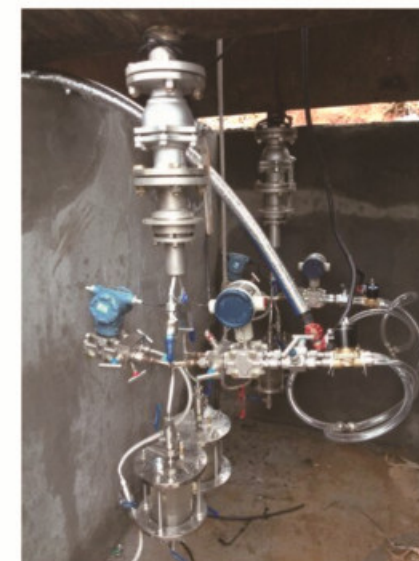
中国石油化工股份有限公司 巴陵石化分公司 介质：不满管排污水 管外径×壁厚：φ426×13mm 压力：常压 温度：常温
