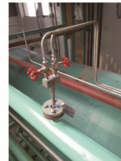
江西安源电厂 介质：除盐水 管外径×壁厚：φ89×4.5mm 压力：0.7MPa 温度：常温
