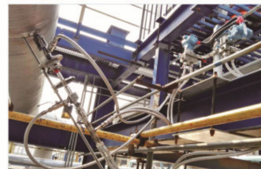
中国石油化工股份有限公司天津石化分公司 介质：火炬气（质量流量） 管外径×壁厚：φ610×10mm 压力：165kPa 温度：176℃
