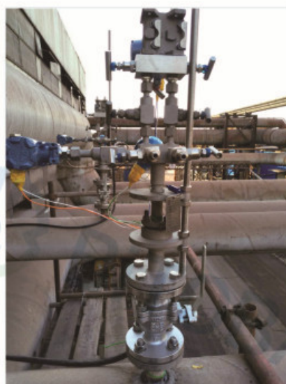
五矿营口中板有限公司 介质：转炉煤气 管外径×壁厚：φ325×8mm 压力：0.02kPa 温度：70℃
