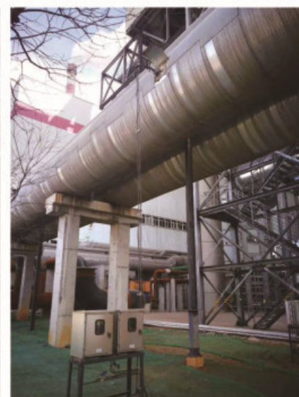
中煤华晋晋城热电有限公司 介质：蒸汽（贸易计量） 管外径×壁厚：φ1620×14mm 压力：0.7MPa 温度：282℃
