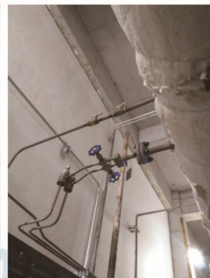
沈阳铁道职业技术学院 介质：蒸汽 管外径×壁厚：φ219×4.5mm 压力：0.9MPa 温度：215℃
