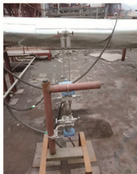
福建罗源宝钢德胜不锈钢有限公司 介质：宽量程蒸汽 管外径×壁厚：φ108×4mm 压力：1.6MPa 温度：320℃
