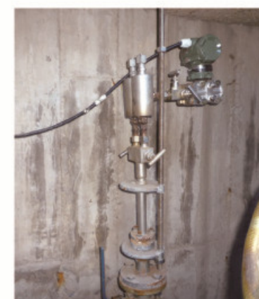
首钢京唐钢铁联合责任有限公司 介质：冲渣水 管外径×壁厚：φ630×10mm 压力：0.35MPa 温度：60℃
