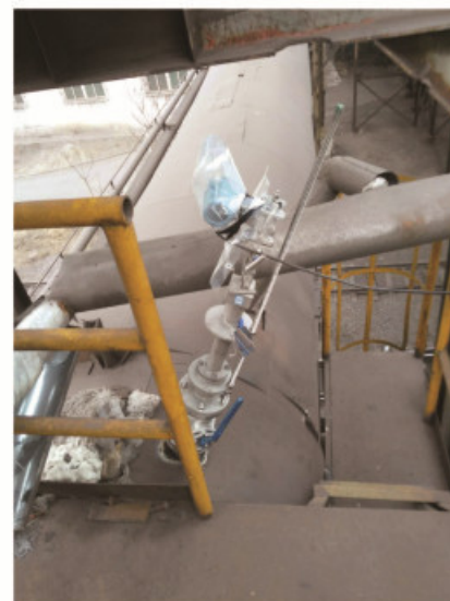
鞍钢集团朝阳钢铁有限公司 介质：转炉煤气 管外径×壁厚：φ1200×10mm 压力：15kPa 温度：常温
