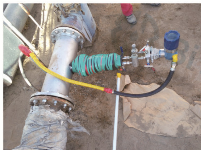
含水原油 用户：西北油田采油一厂一号计转站
