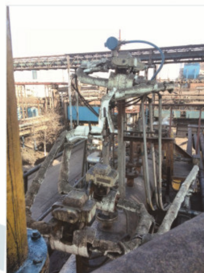
济南钢铁股份有限公司 介质：荒煤气（5号焦炉） 管外径×壁厚：φ426×13mm 压力：8kPa 温度：700℃
