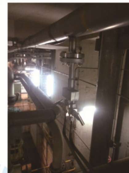
辽宁华电铁岭发电有限公司 介质：内冷水 管外径×壁厚：φ89×4.5mm 压力：0.6MPa 温度：40℃
