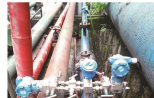
中国石油化工股份有限公司巴陵石化分公司 介质：氢气 管外径×壁厚：φ159×4.5mm 压力：0.82MPa 温度：25℃
