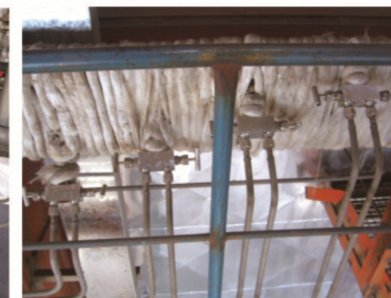
包头山晟新能源哈拉旗电厂 介质：减温水 管外径×壁厚：φ27×4mm 压力：8MPa 温度：215℃
